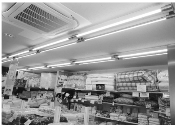
横浜市内の寝具店では、LED照明管「SIMPLE-TUBE」を店内全域で導入。電気代の実質値下がり分で、経費をかけずに蛍光灯をLED化できたようなもので、商品の色やけ防止にもなったという。
