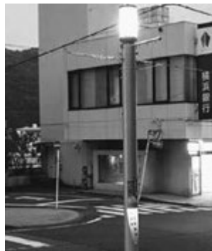
湯河原駅前通り明店街では、既設片流アーケードを撤去して街路灯を新設しました。商店街名を柱に表示してLED光源による投光照明です。近い将来、電線地中化されます
